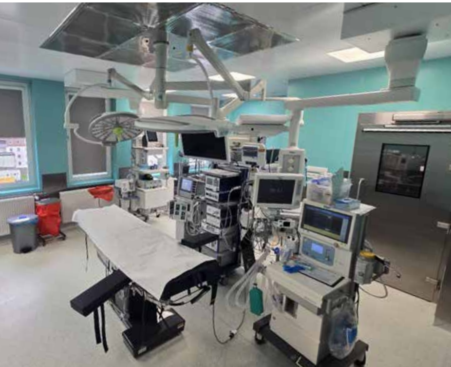
Wyposażona w najnowocześniejszy sprzęt sala operacyjna szpitala w Grójcu
